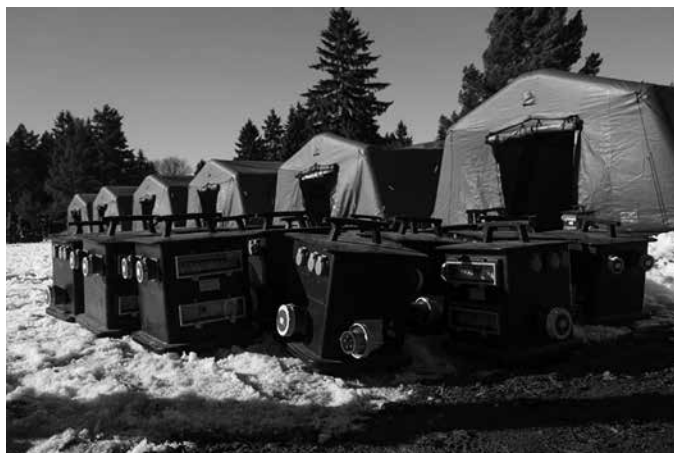
Obrázek č. 18: Rozvodné skříně před zapojením
